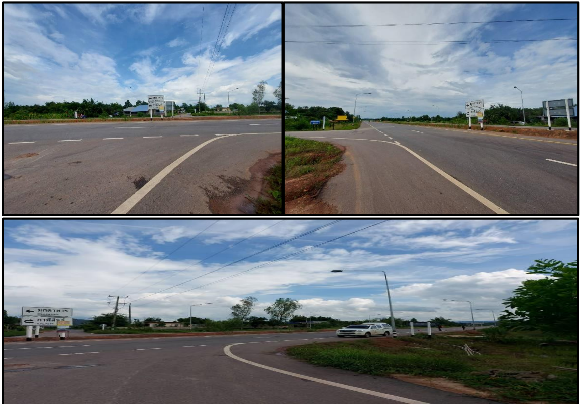
ภาพที่ ๓.๑๗ สภาพถนนบริเวณถนนสี่เลนสร้างใหม่บ้านโคกป่าหวาย - ดงภู อ.คำชะอี
