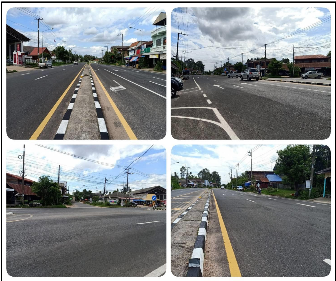
ภาพที่ ๓.๑๖ สภาพถนนบริเวณหน้า อบต.หนองเอี่ยน ต.หนองเอี่ยน หมู่ที่ ๑ อ.คำชะอี
